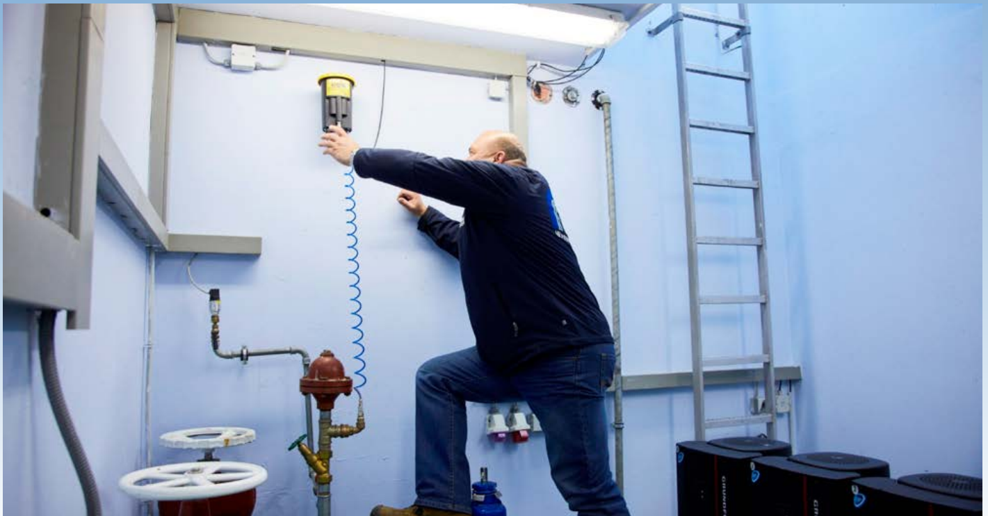
Roland Kainz sjekker XiLog-trykksensoren på pumpestasjonen som står nedstrøms i Opping. Den sender data via GSM til DDD-styringen i Wolkertsham.
