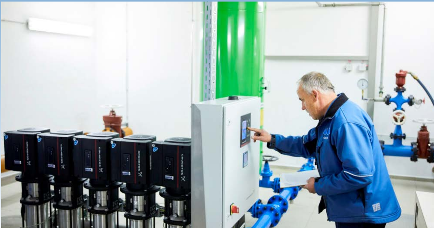
Günter Meisl, sjefstekniker ved ZWR, tar sine daglige runder ved hovedpumpestasjonen i Wolkertsham med Grundfos Demand Driven Distribution System CU-styringen.
